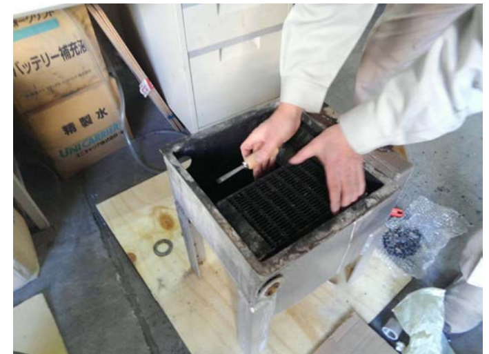
写真6：メンテナンスのため、本体分解を行うところ。 ノズルのナットを分解すると本体は容易に分解ができた。 ケース下部のドレンパン部には、大量のスス及びボイラー からの排出される重油固形物である石状の堆積物が流入 されていることから、厳しい汚れ環境であったことが 想像できた。
