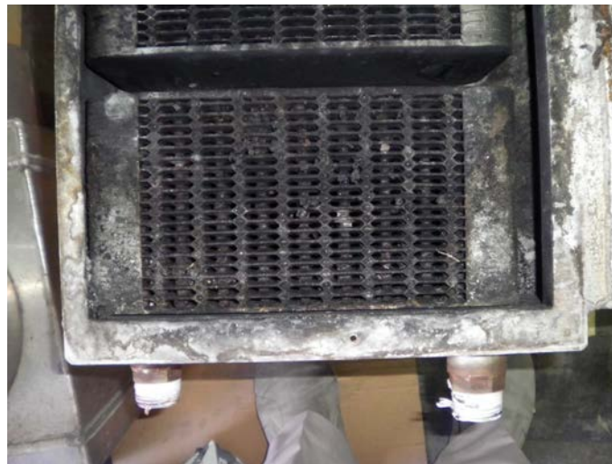
写真5：試験終了後のニッケルロウ付プレート+アルミナイズド 処理熱交換器 本体への硫酸水による腐食原因による孔食ピンホールは 確認できなかった。こちらもススの堆積は非常に多いが 通風経路は閉塞しておらず、熱交換を維持していると思 われる。アルミナイズド処理の分、経路が狭くなっている
