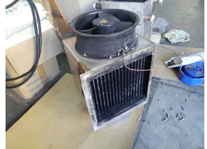
写真3：硫酸水製造用フィン無しアルミ製ガス/ガス熱交換器 排ガス入口部を撮影。スス汚れがひどい
