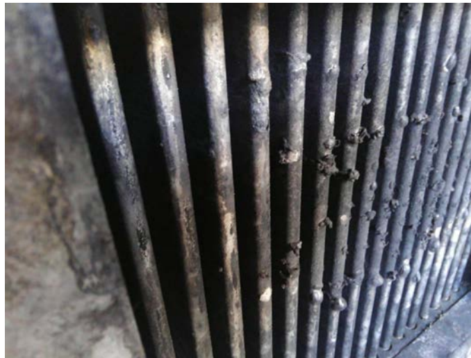
写真10：硫酸発生用フィン無しアルミ熱交換器の排ガス接触部。このチューブ端部に硫酸水が滴っていたと想像される。特段、腐食による孔食、減肉部は発見されなかった。
