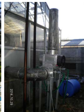
実際のテスト機設置状況
