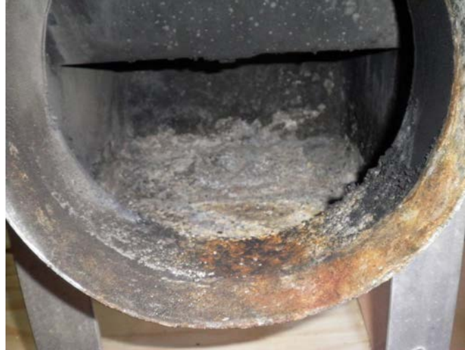
写真2：本体排ガス入口部、ドレンパン内部 ドレンノズル閉塞による内部にドレン水が堆積、 本体内部が腐食している状況を確認できる
