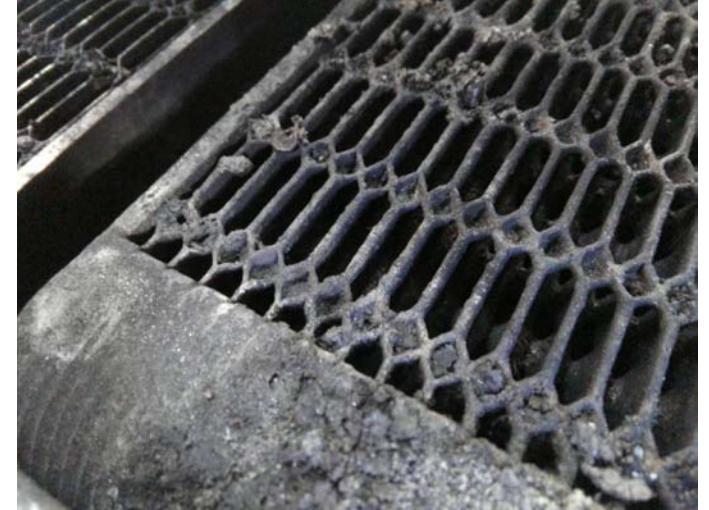
写真9：ニッケルロウ付+アルミナイズド処理の試験後の拡大部。排ガス流路がアルミナイズドの腐食による膨張により若干狭い流間になっている感じが見受けられる
