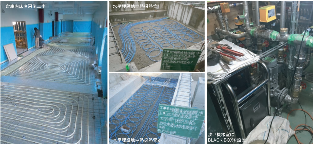
倉庫内運転前
