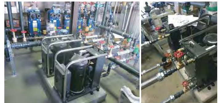
蔵王温泉ホテル様 温泉加熱/床暖房/床冷房/温泉排水熱回収用2台
