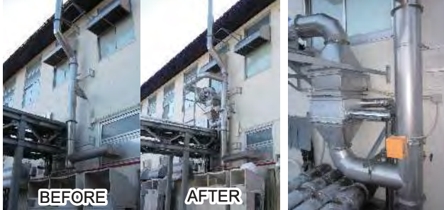
山梨県 大手食品工場様 ボイラー排熱回収
